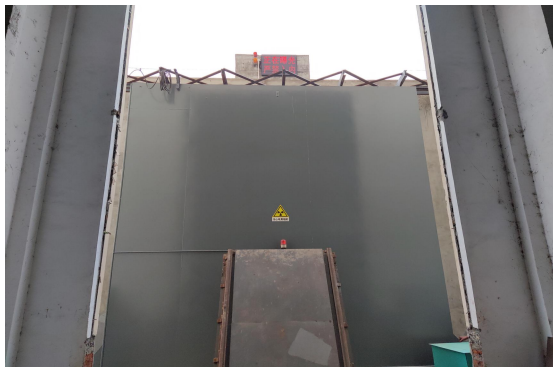
工件大门外警示标示及工作状态指示灯
