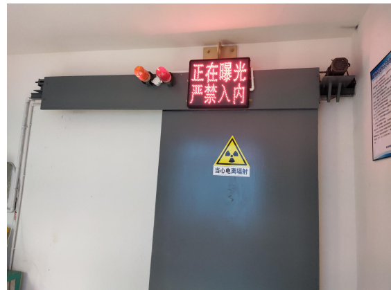
迷道防护门警示标示、指示灯
